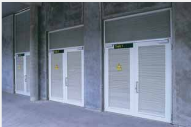
"Teckentrup" transformer doors, dw 54-2
